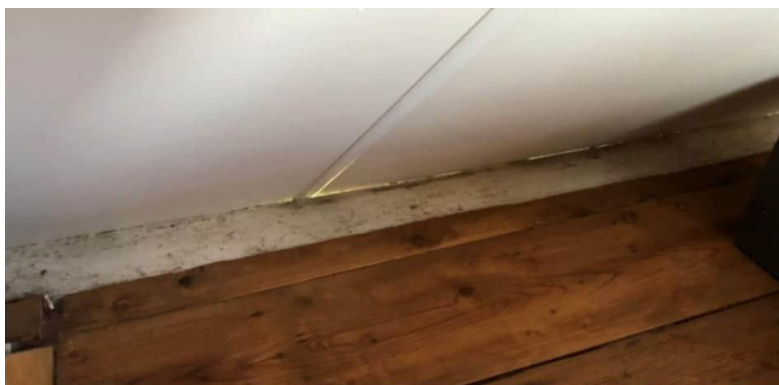
Voorbeeld van extreme kier tussen vloer en dak. Hier zie je licht van buiten. Foto Lars Boelen Paris-Proof-Plan
